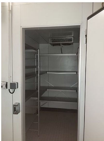
Vue sur l'intérieur de la chambre froide
